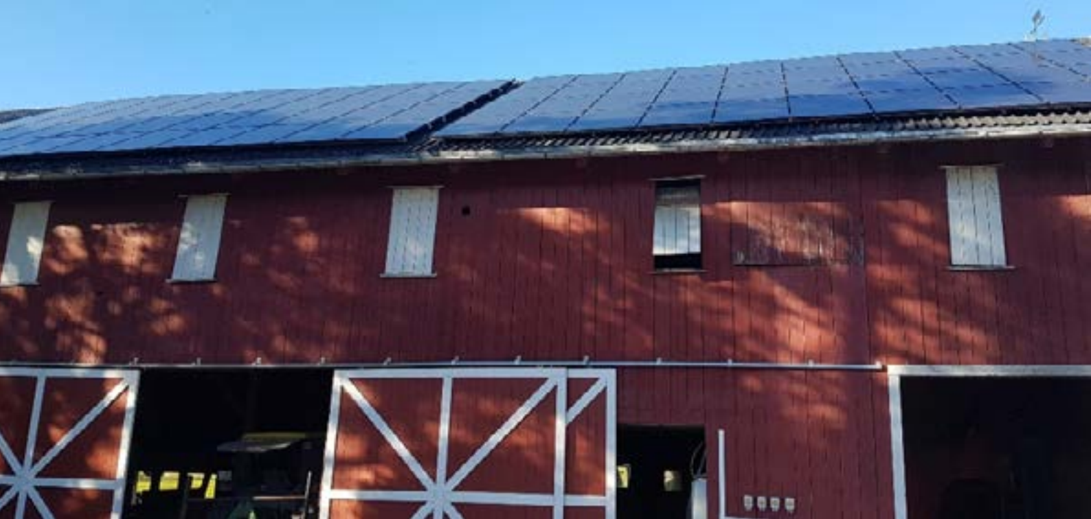
Figur 28: FERDIG OPPSATT SOLSTRØMSANLEGG PÅ LÅVEN.
