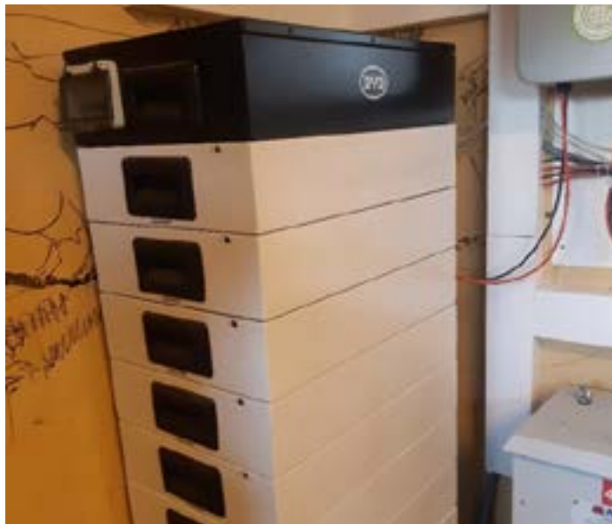
Figur 7: LI-ION BATTERITÅRN LEVERT AV ONECO
