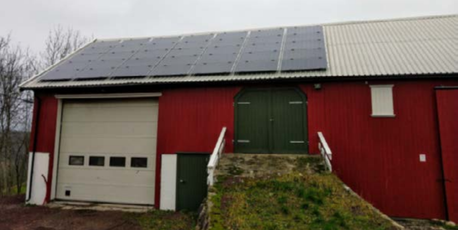
Figur 20: GLASS – GLASS SOLSTRØMANLEGG FRA SAGA ENERGY.
