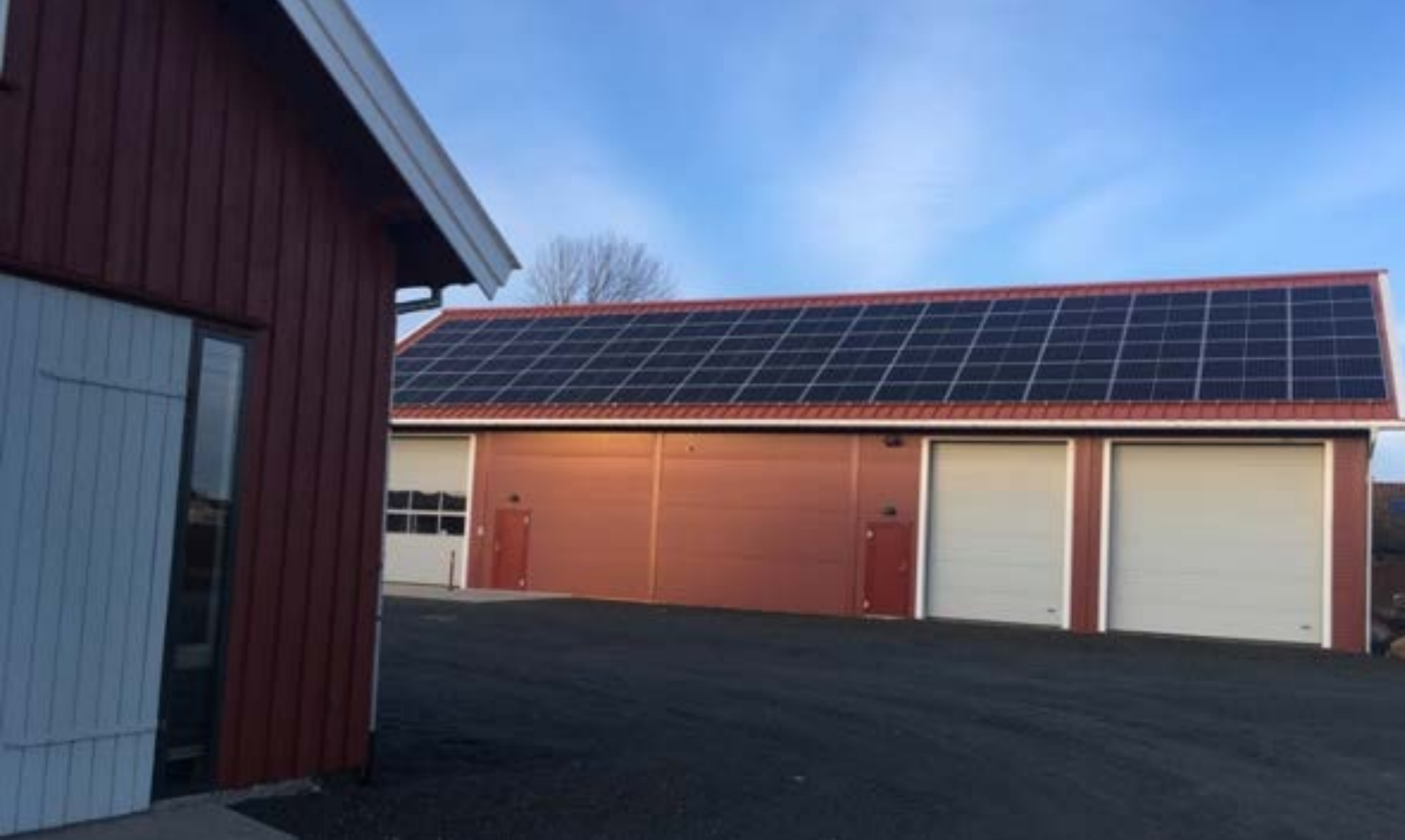
Figur 31: FERDIG SOLSTRØMSANLEGG PÅ BYGNING MED GRØNNSAKSKJØLER.
