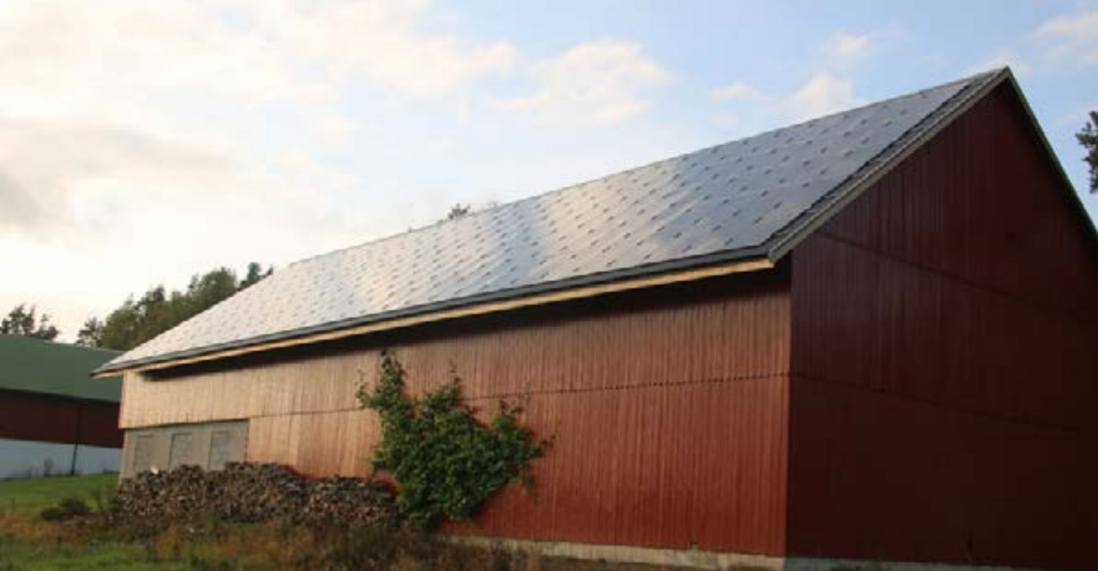
Figur 26: BONDEN ER FERDIG MED INSTALLASJONEN AV 35 KWP GLASS – GLASS PANELER.
