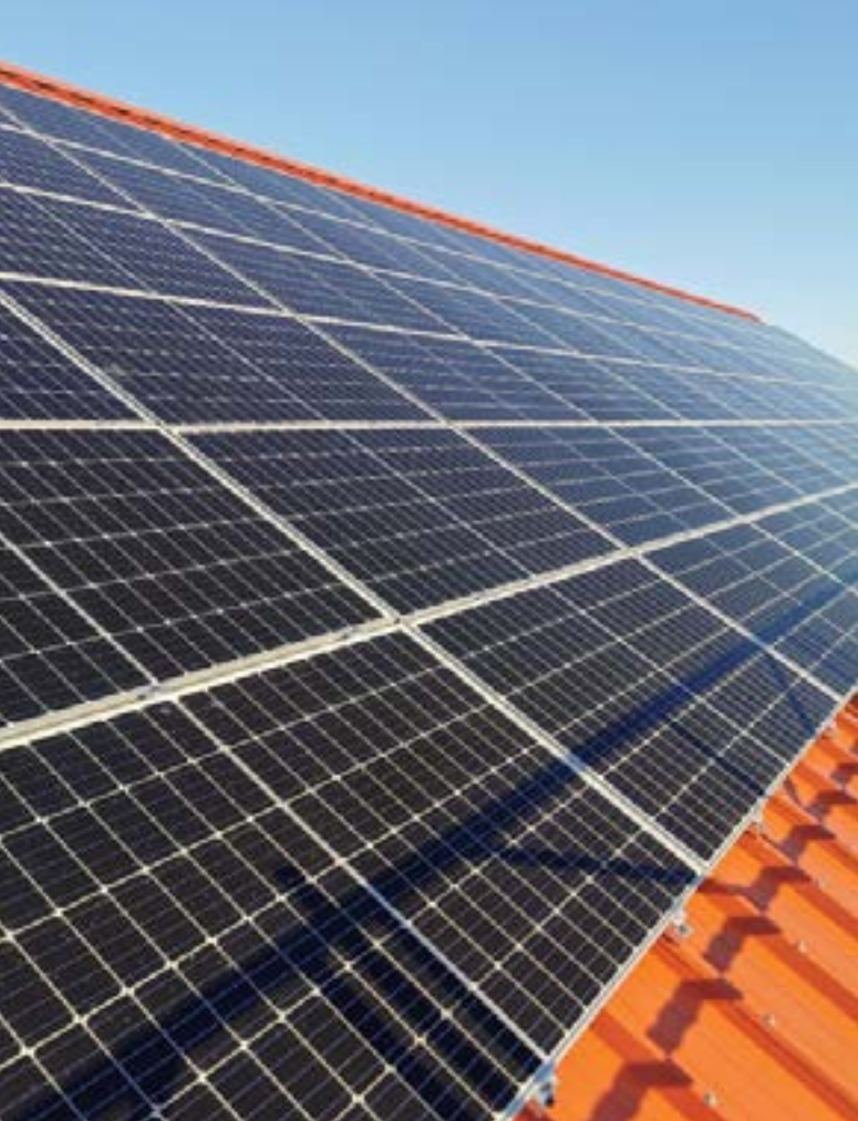
Figur 33: 90 STK. 330 WP PANELER. MESTEPARTEN AV STRØMMEN FORDELES PÅ BATTERI OG KJØLEBYGNING OG RESTEN FORDELES TIL GÅRDSUTSALG.
